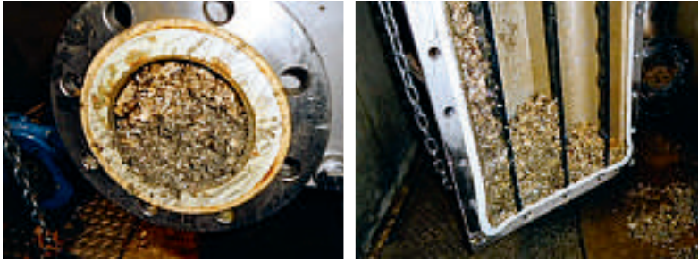
Kein Durchkommen mehr für Wasser. Die Muscheln machen Leitungen und Filter dicht.
